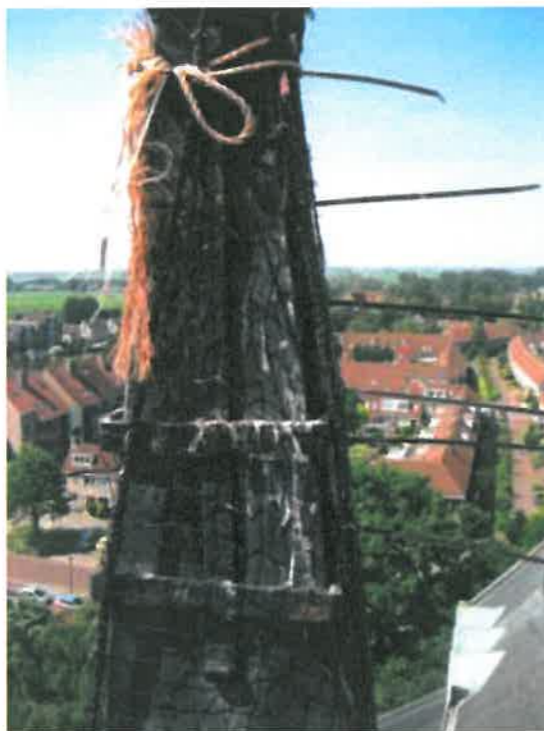
Foto 106 Het ijzerwerk van de kruizen is slecht.
