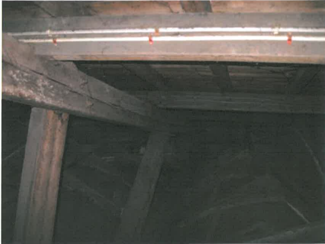
Foto 45 De spanten van het schip buigen sterk door.
