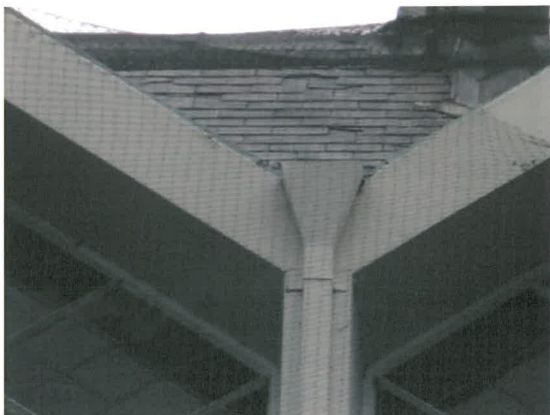
Foto 12 Diverse gebroken en weggevallen leien onder de dakruiter.
