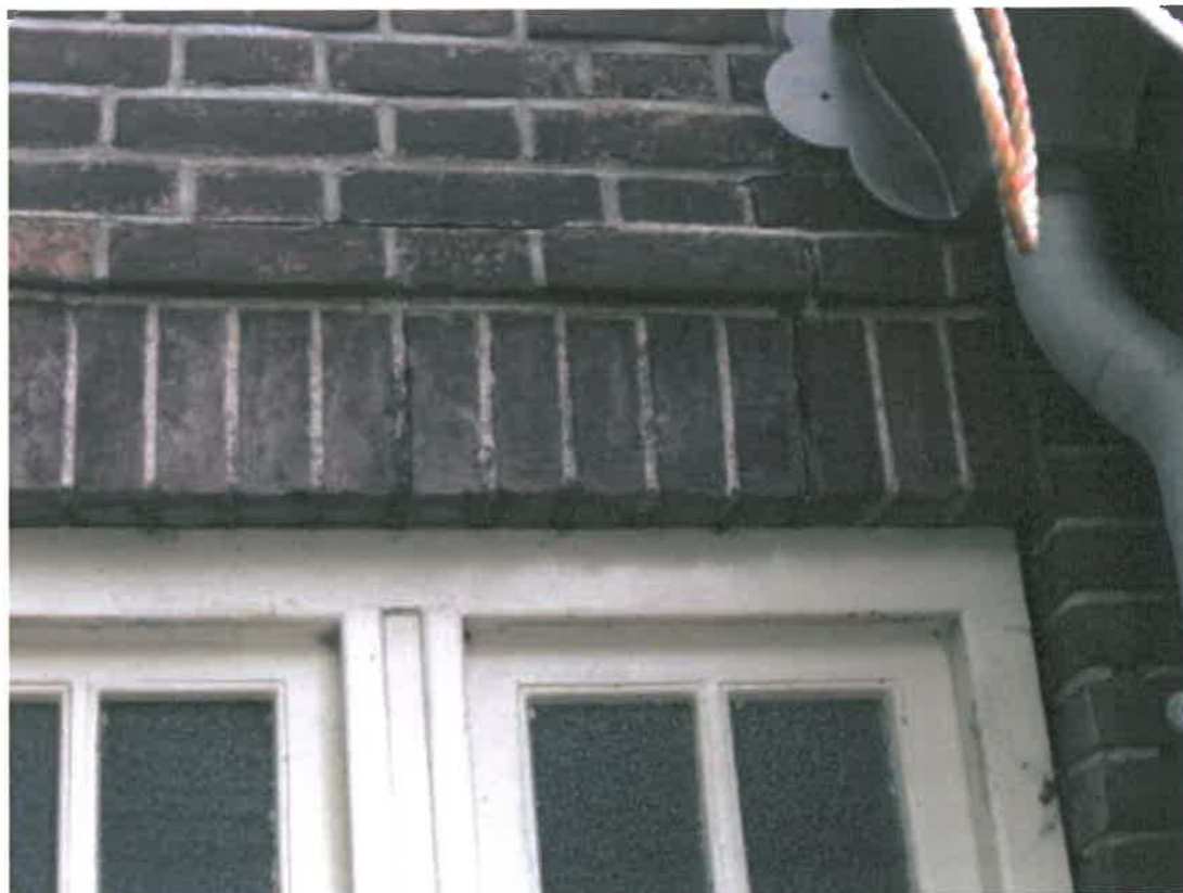
Foto 136 De rollaag op het raamkozijn is gescheurd en zit deels los.
