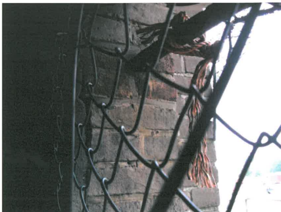
Foto 52 Scheur in het metselwerk t.p.v. het ringanker.
