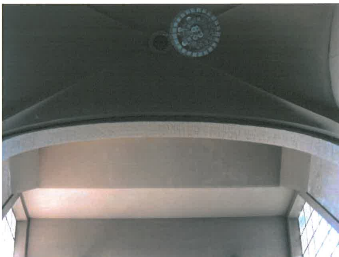
Foto 124 Scheur langs het plafond t.p.v. het nieuwe koor.
