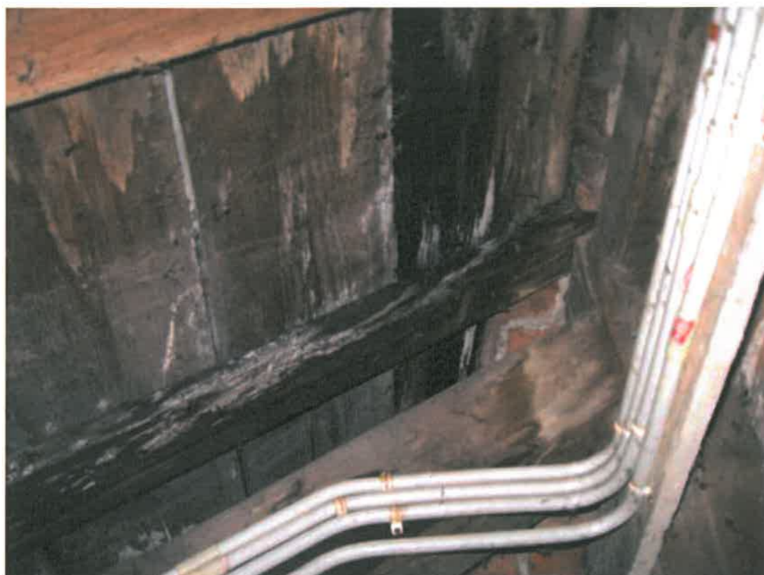
Foto 30 Door houtrot en schimmel aangetast houtwerk a.g.v. lekkage.
