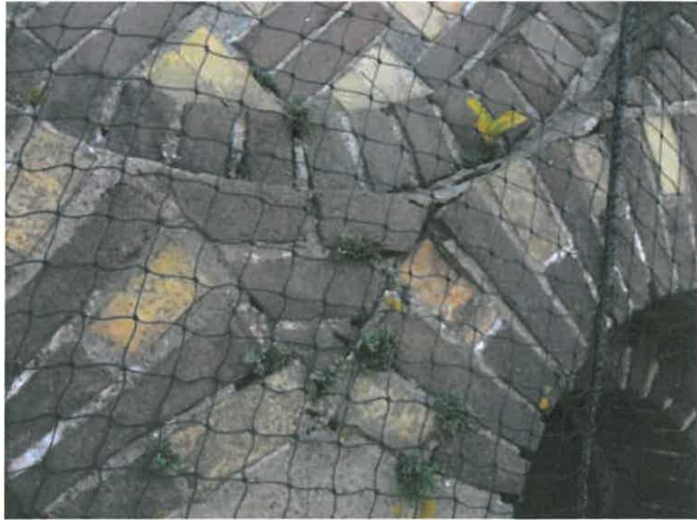
Foto 79 Slecht voegwerk en plaatselijk een beschadigde steen.
