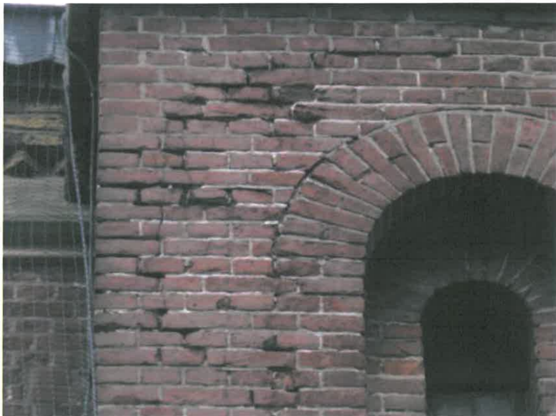
Foto 65 Slecht metselwerk in de toren.
