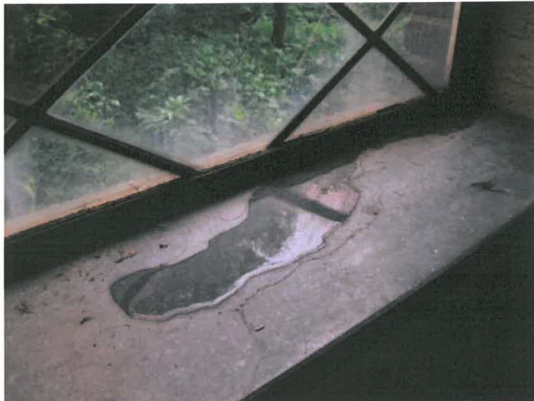
Foto 111 Water op de vensterbank a.g.v. lekkage van het glas in lood.
