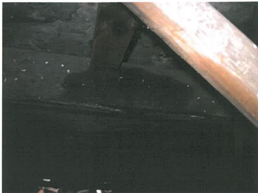
Foto 25 Natte plek op het houtwerk van een torenspits a.g.v. lekkage.
