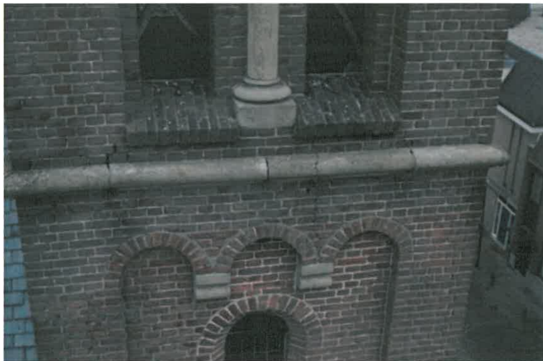
Foto 80 Scheur in het metselwerk en plaatselijk slecht voegwerk.
