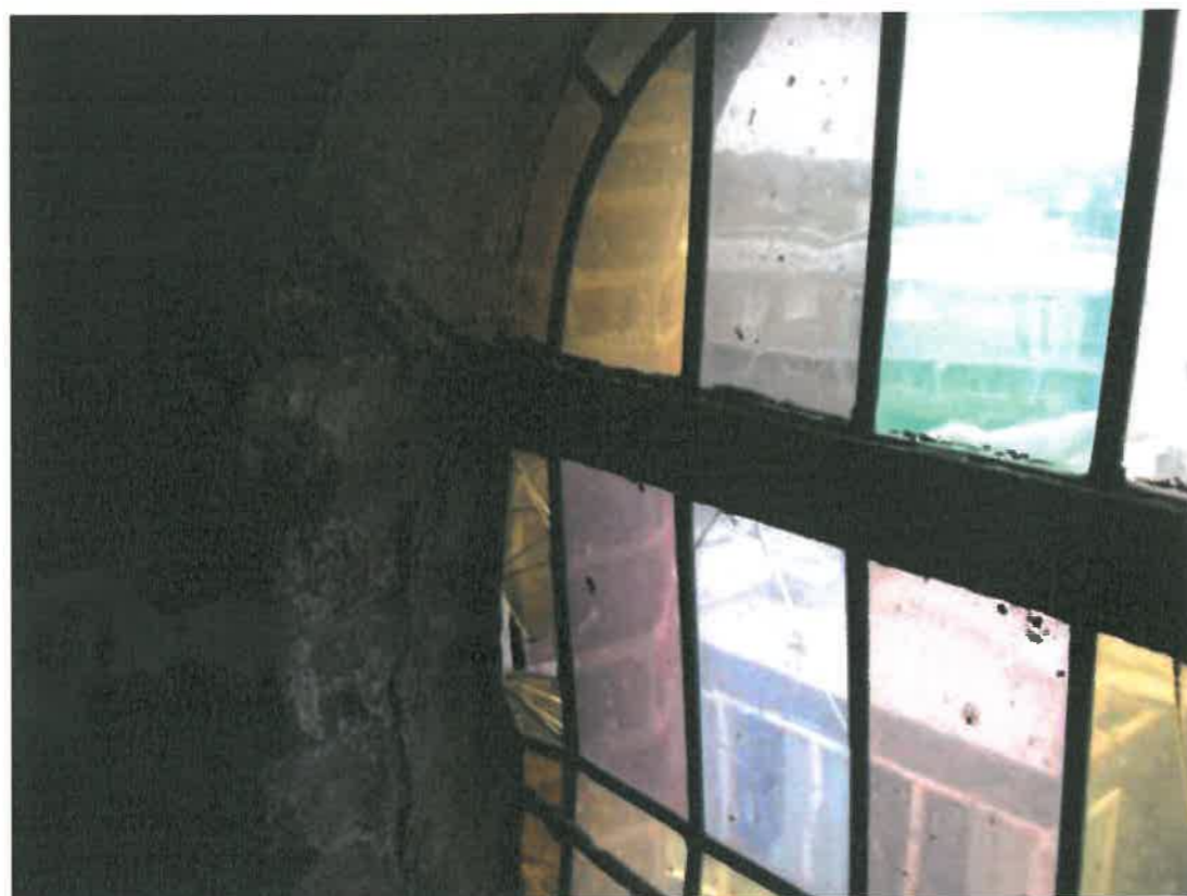
Foto 50 Slecht glas in loodraam in de toren.
