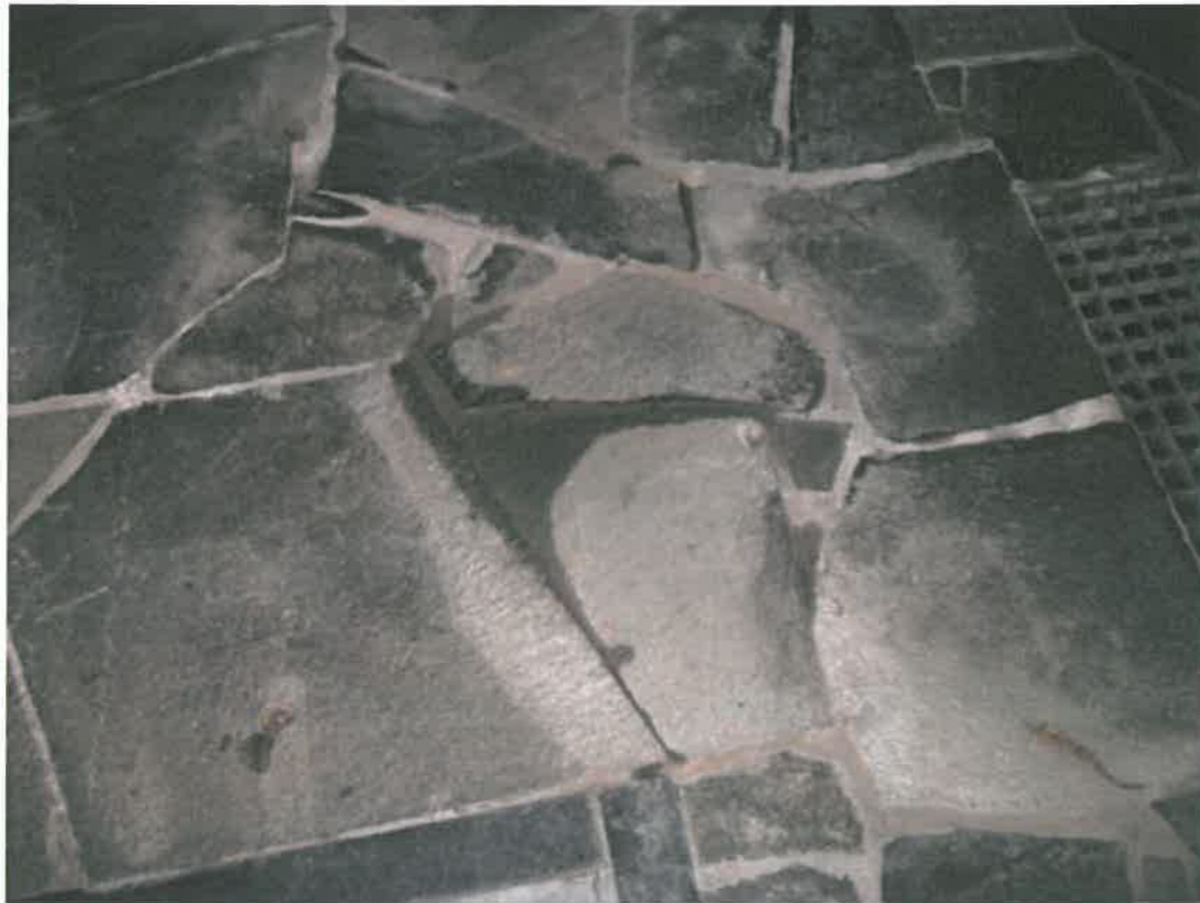
Foto 113 Water op de vloer van de kerk a.g.v. lekkage.
