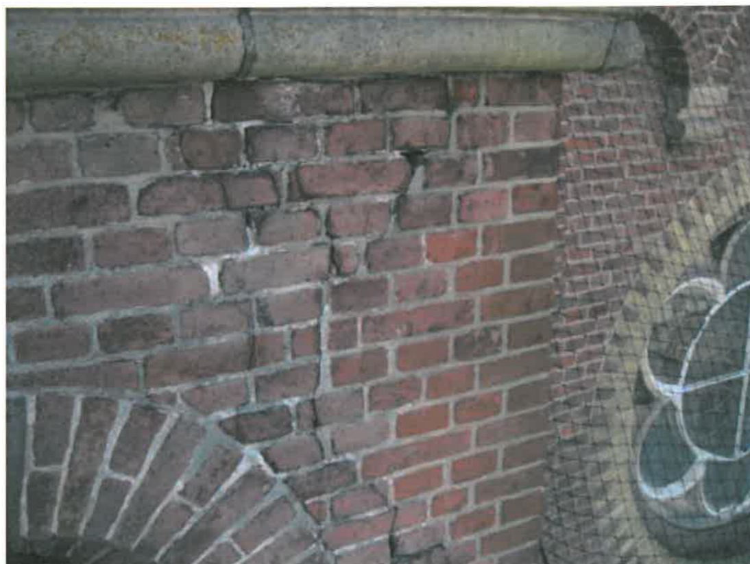
Foto 76 Scheuren in het metselwerk.
