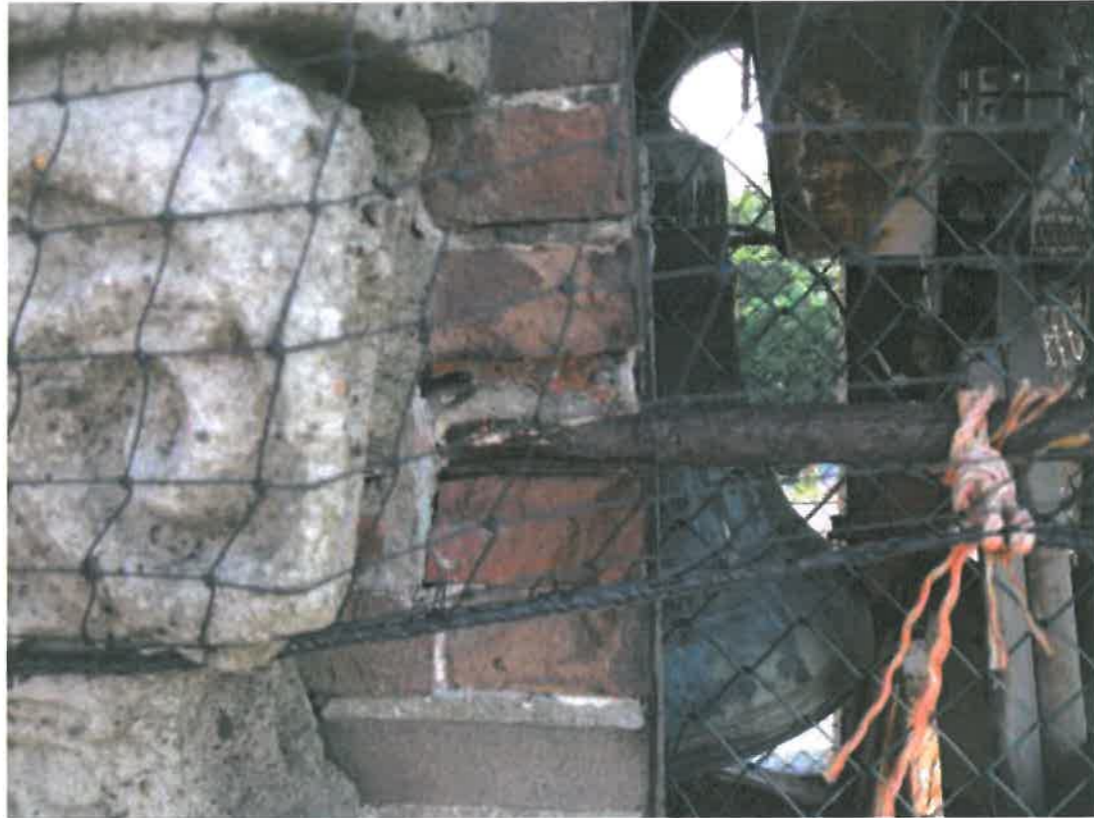
Foto 71 Weggefallen stenen t.p.v. het ernstig corroderende ringanker.
