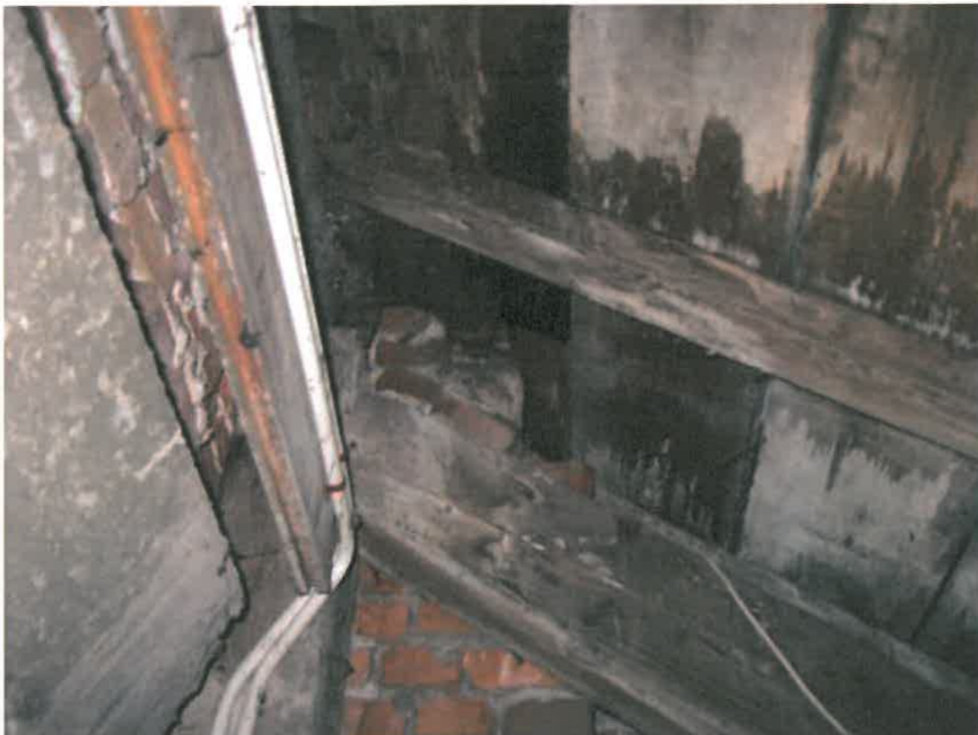
Foto 40 Door vocht aangetast houtwerk a.g.v. lekkage.
