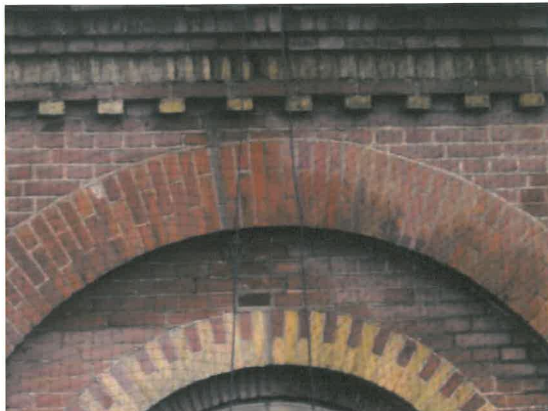
Foto 94 Nat muurwerk a.g.v. lekkage van de goot.
