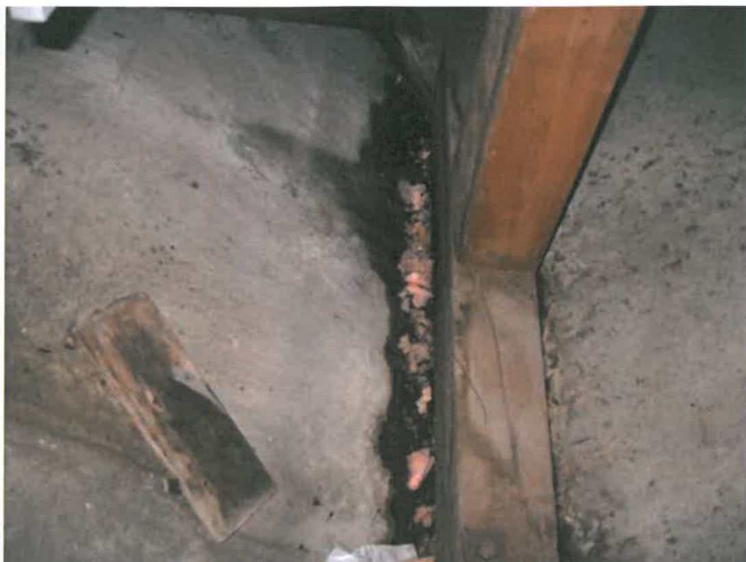
Foto 41 Door vocht aangetast houtwerk onder de dakruiten a.g.v. lekkage.
