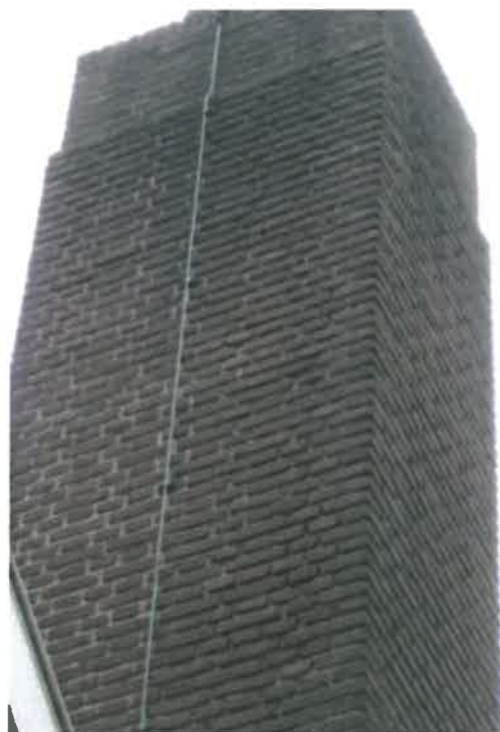
Foto 133 Slecht voegwerk van de schoorsteen op de lage aanbouw.
