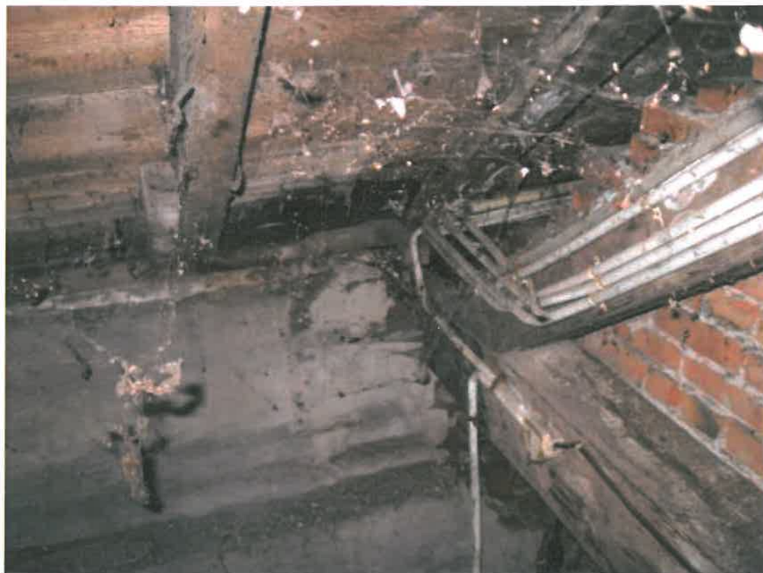
Foto 31 Door vocht aangetast houtwerk van dakbeschot en spant a.g.v. lekkage.
