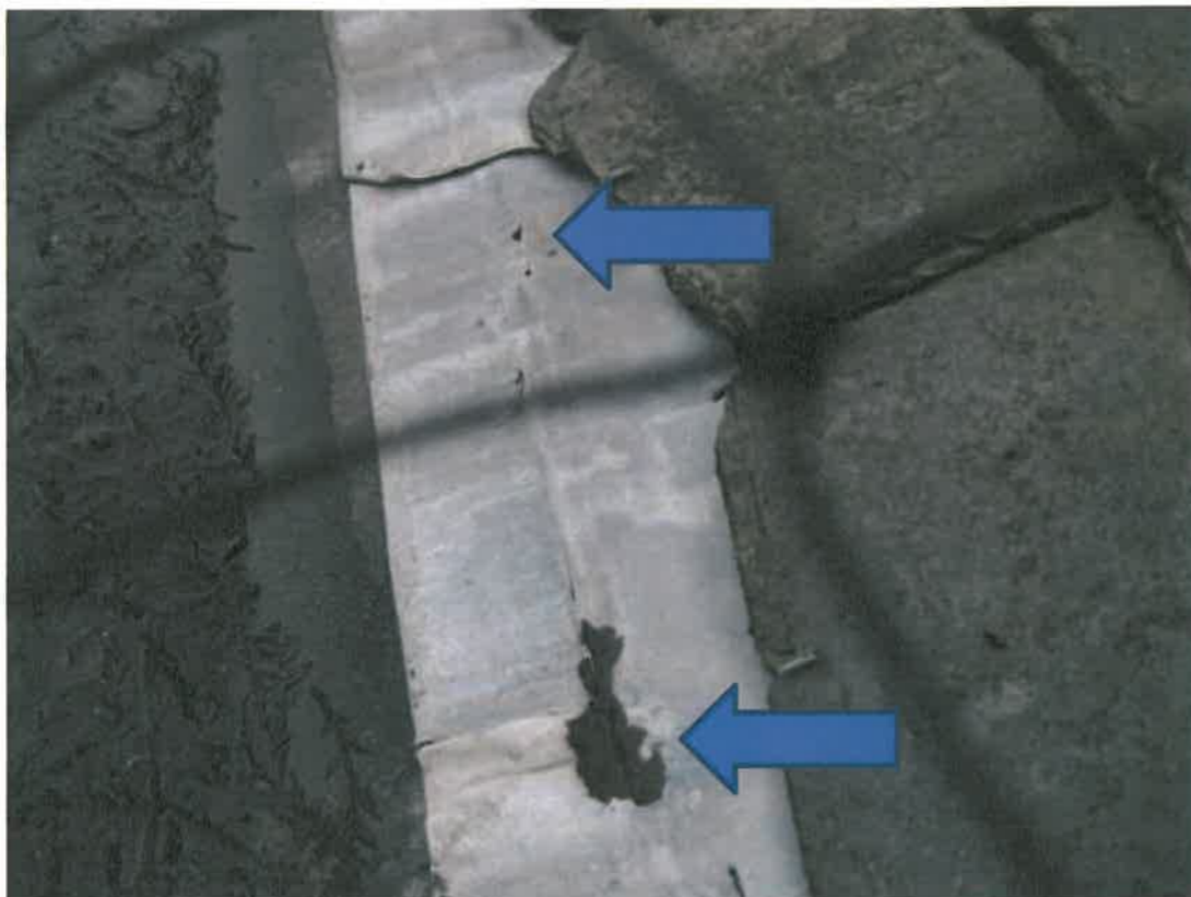
Foto 24 In het voetlood zijn diverse gaten en scheuren aanwezig.
