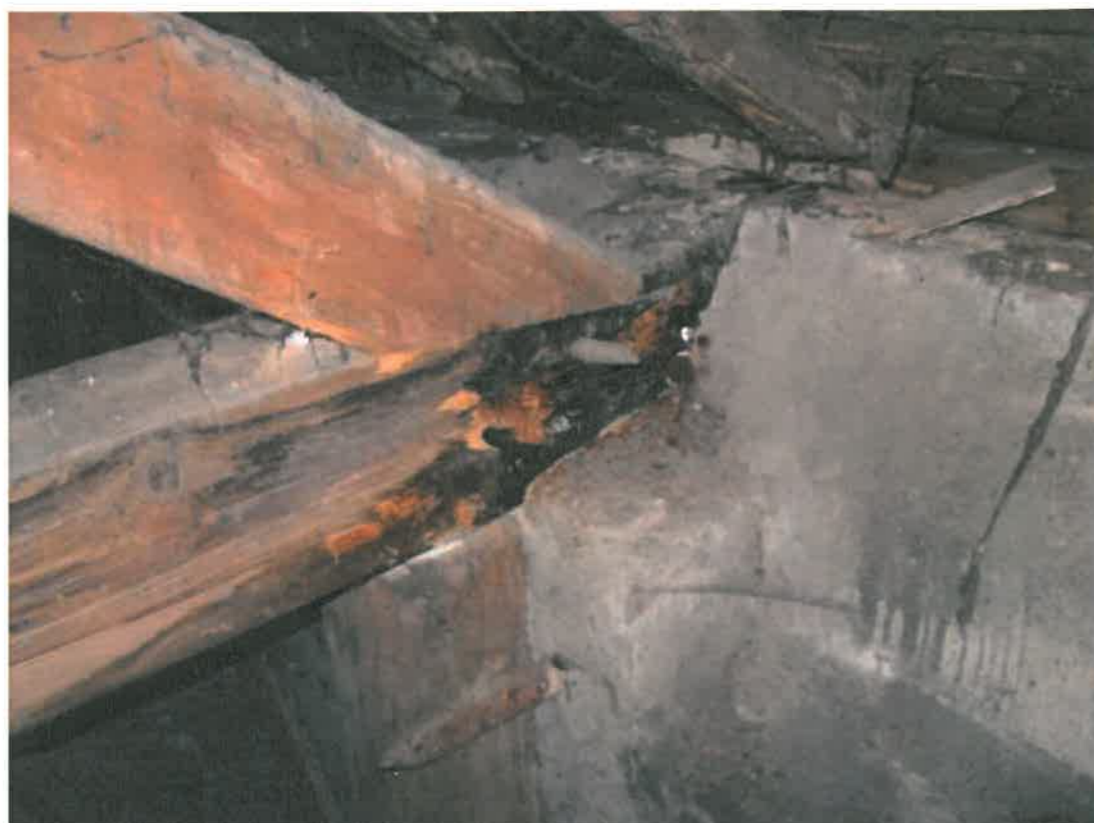
Foto 38 Door houtrot aangetast spant a.g.v. lekkage.
