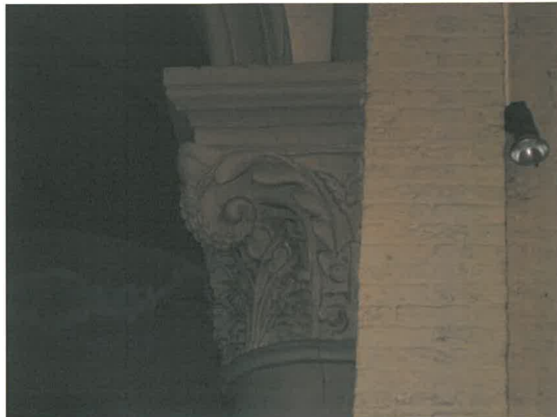
Foto 126 Het kapiteel is gescheurd.
