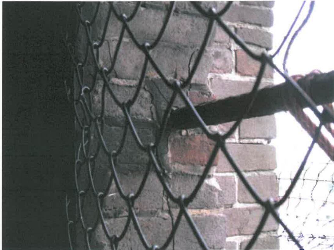
Foto 55 Gescheurd metselwerk a.g.v. het corroderen van het ringanker.
