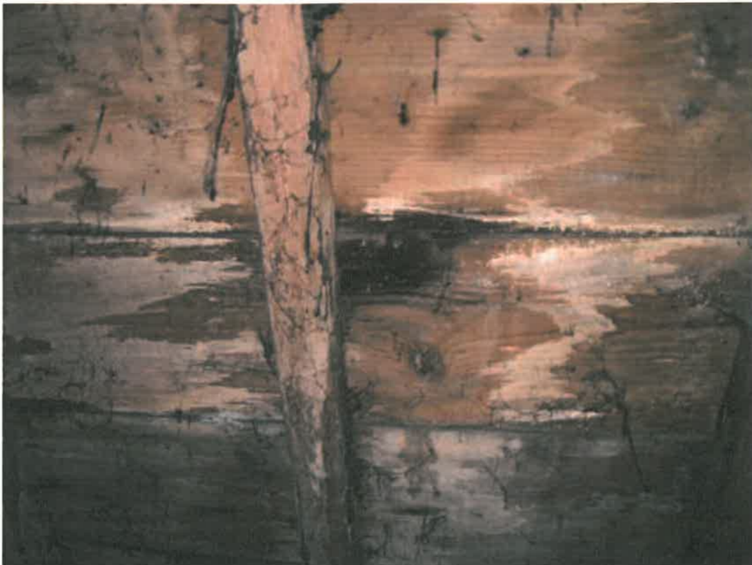
Foto 34 Een van de vele natte plekken in het dakbeschot a.g.v. de slechte leibedekking.
