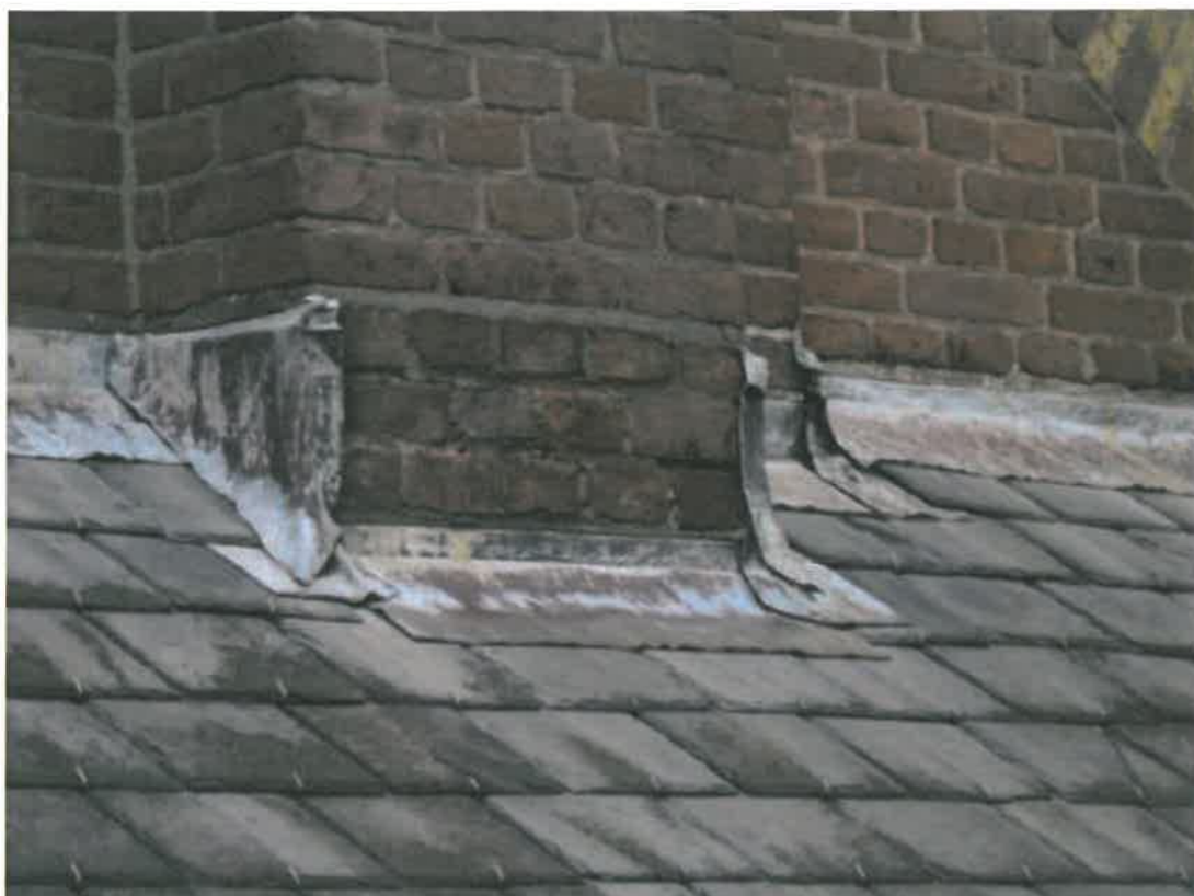
Foto 21 Matig muurlood boven de leien.
