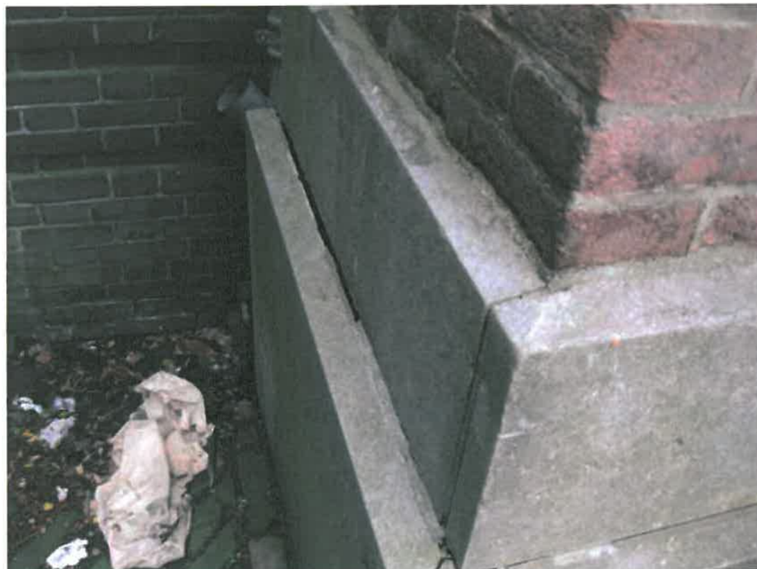
Foto 96 Los geraakte hardstenen plint.
