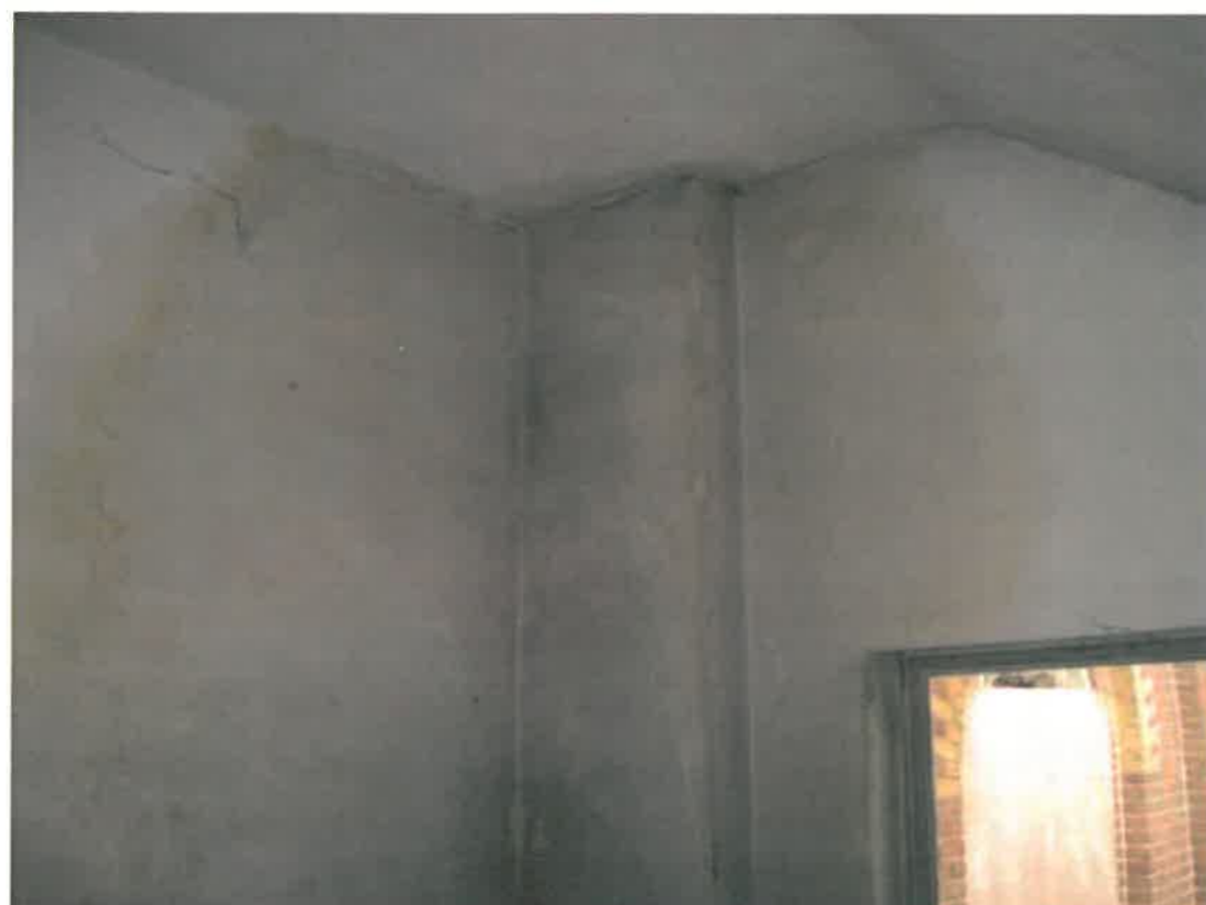
Foto 118 Door vocht aangetast pleisterwerk a.g.v. lekkage.
