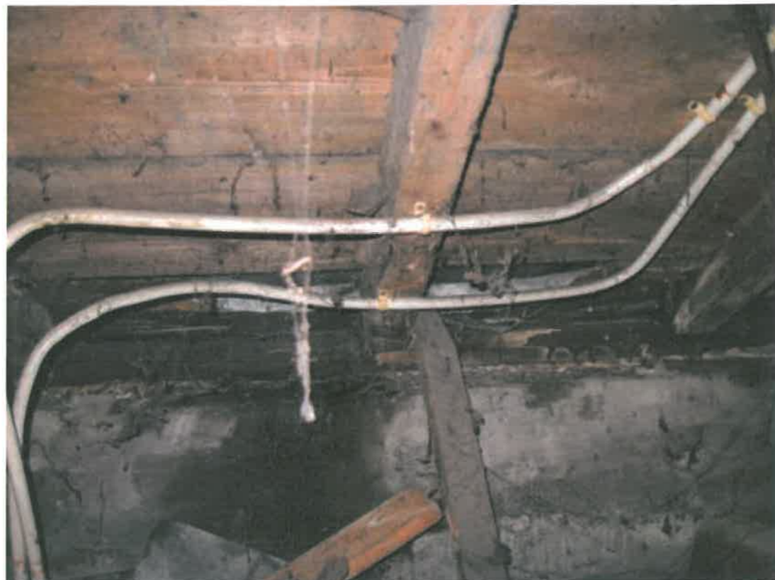
Foto 37 Door houtrot en zwam aangetast houtwerk a.g.v. lekkage.
