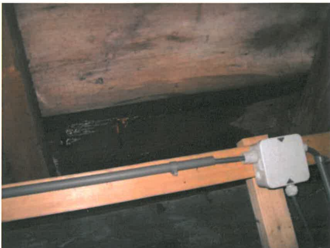
Foto 32 Door vocht en schimmel aangetast hout a.g.v. lekkage.
