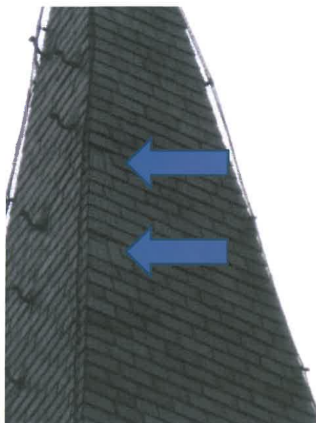
Foto 9 Weggefallen leien van de toren.
