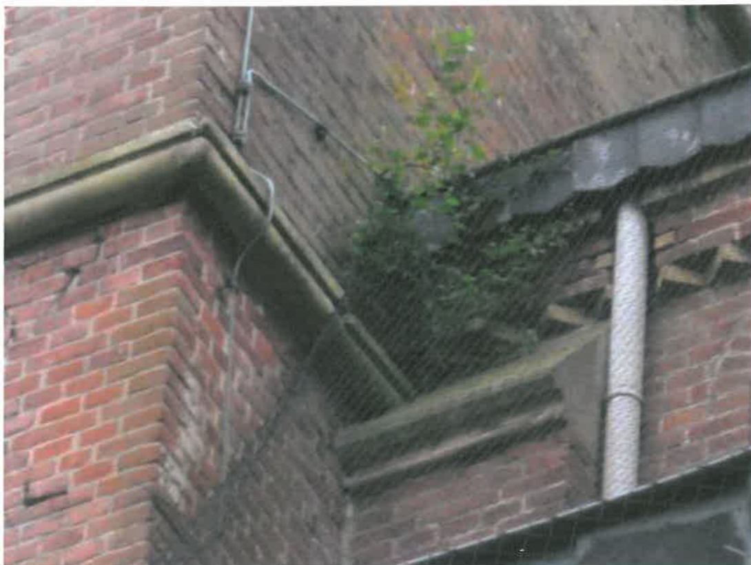
Foto 77 Een boom groeit in het metselwerk van de toren.
