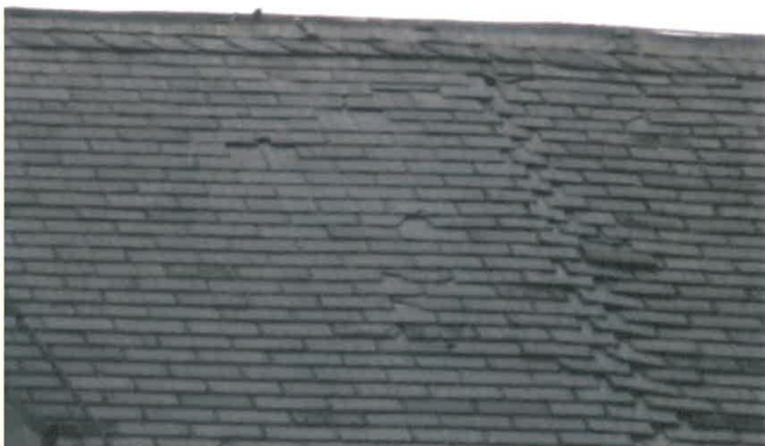
Foto 14 Slechte leibedekking t.p.v. de overgang schip nieuwe koor. Verspreid diverse weggevallen leien.
