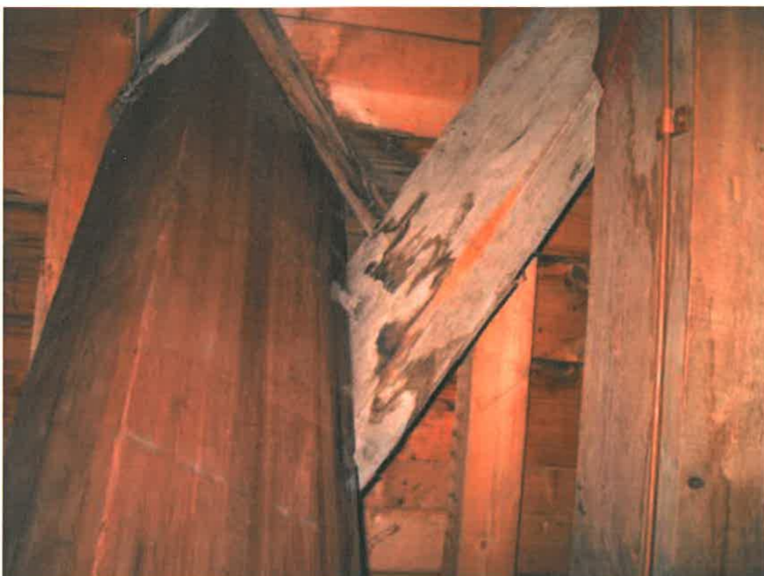
Foto 42 Nat houtwerk a.g.v. lekkage t.p.v. de dakruiten.
