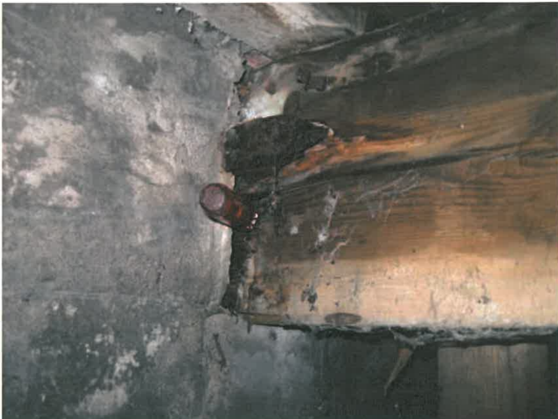
Foto 46 Door houtrot aangetaste balk in de toren.
