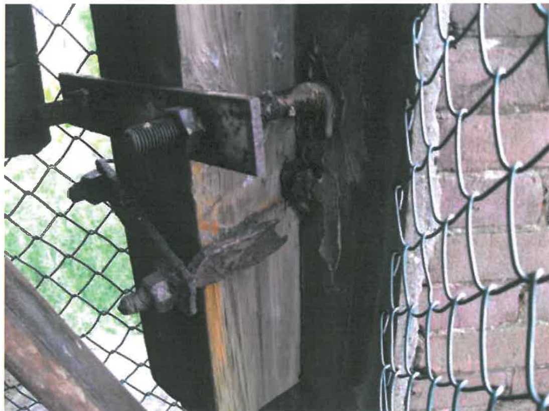
Foto 63 Afgebroken verankering in de toren.
