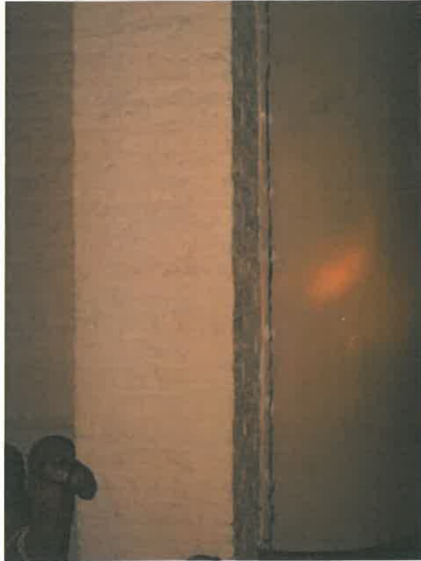
Foto 125 Scheur tussen het nieuwe muurwerk en de bestaande kolom.
