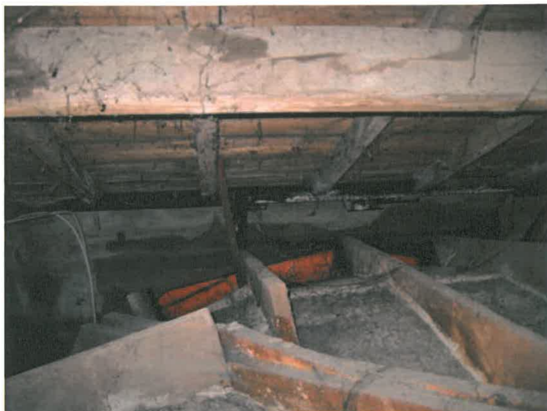
Foto 26 Ernstige lekkage t.p.v. de goot van de zijbeuk.
