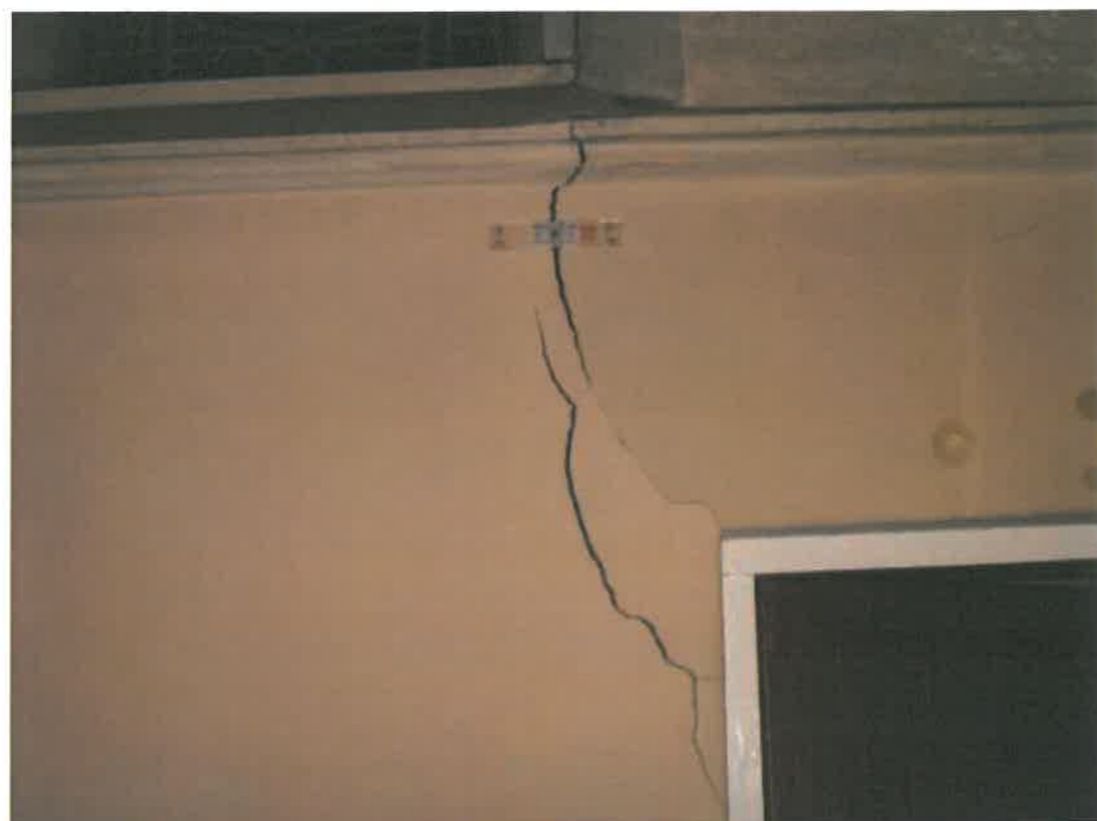
Foto 127 Scheur boven een kozijn. Er is al een scheurmeter geplaatst.
