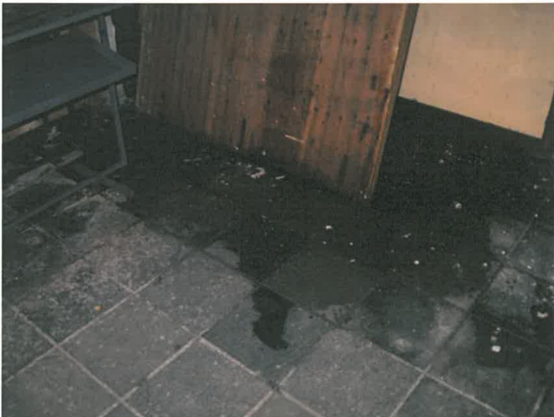
Foto 114 Veel water op de vloer a.g.v. ernstige lekkage.
