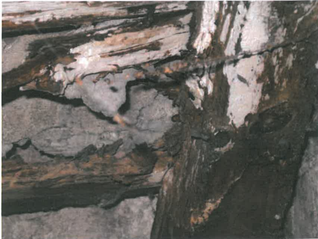
Foto 27 Door houtrot en zwam aangetast houtwerk a.g.v. lekkage.
