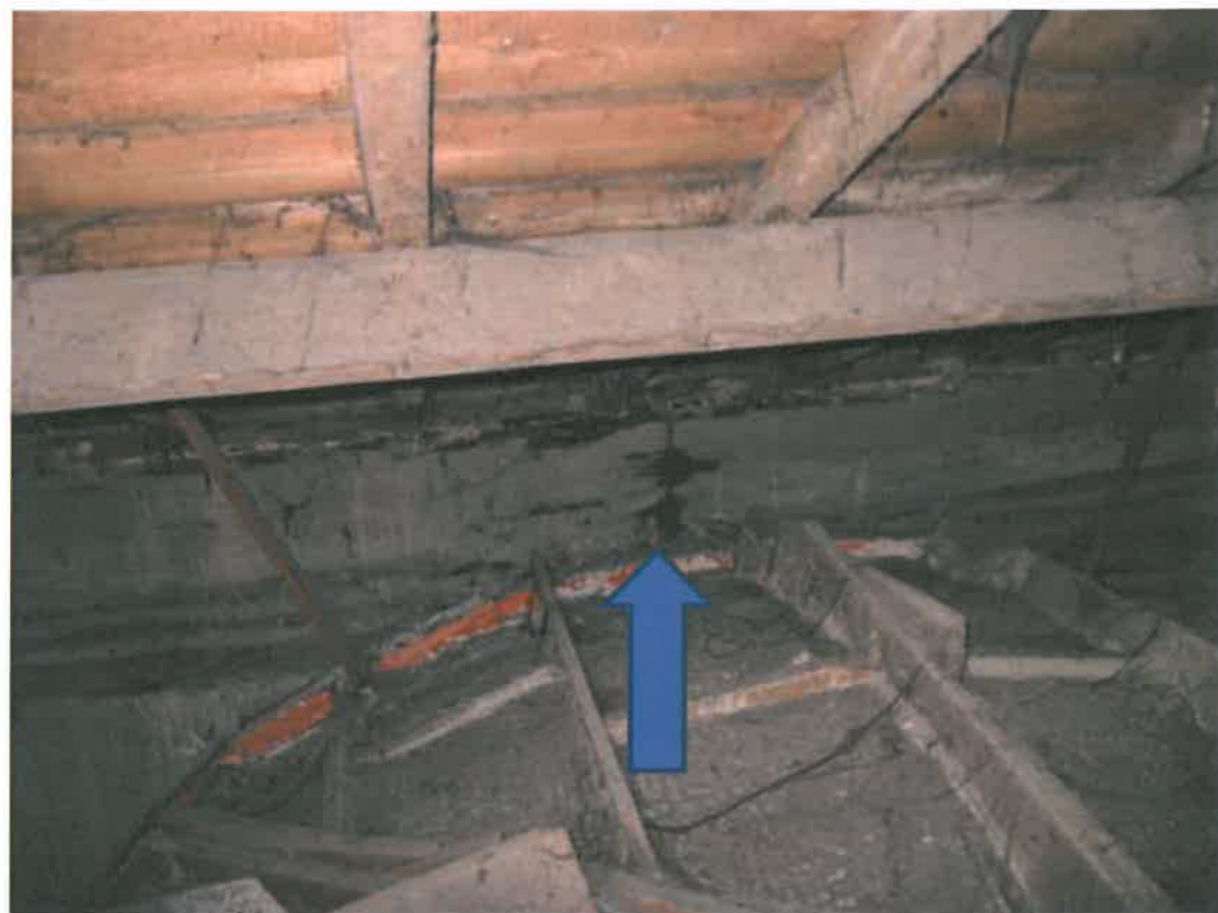
Foto 29 Natte plek onder de goot a.g.v. lekkage.
