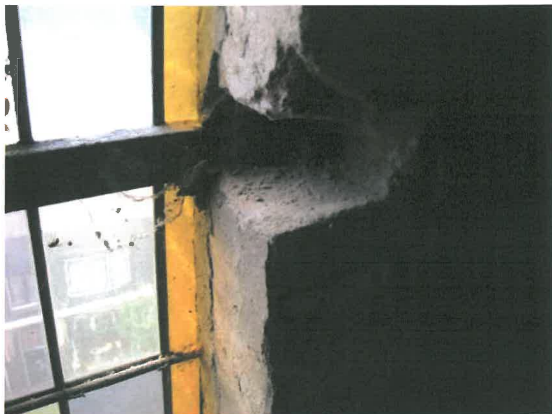
Foto 51 Door corrosie aangetast brugijzer.
