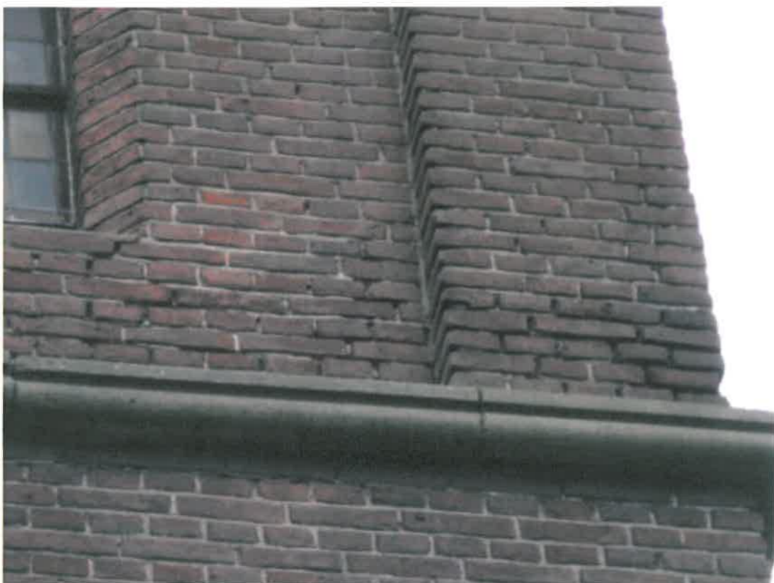
Foto 66 Slecht voegwerk toren.
