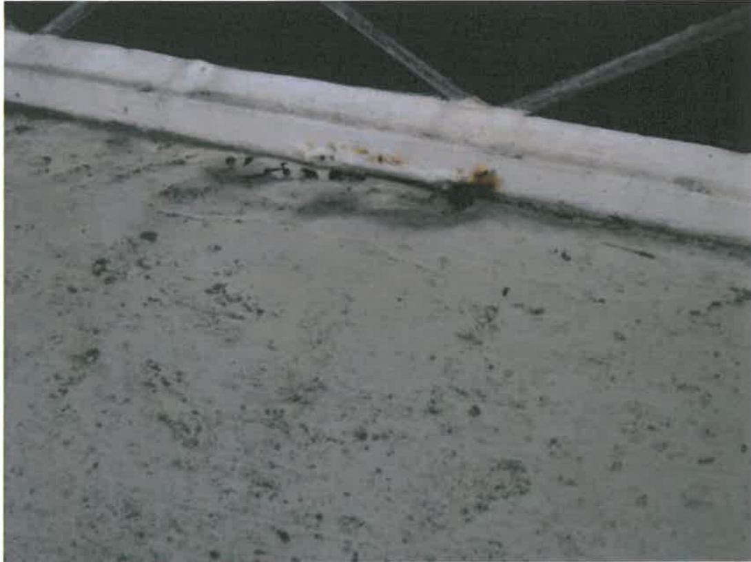
Foto 101 Corrosievorming op het stalen raam.
