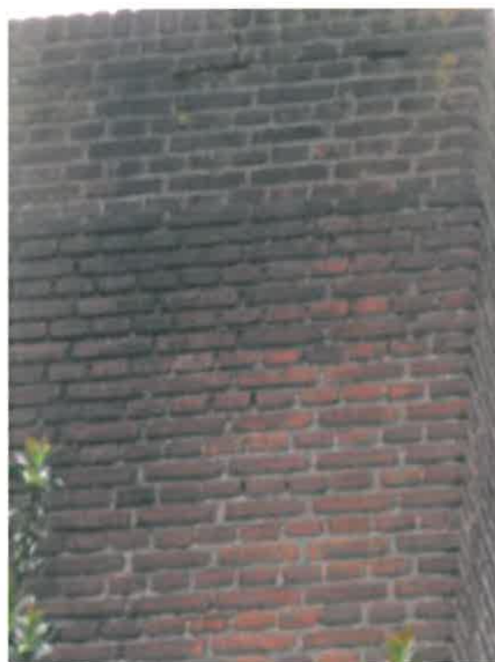
Foto 134 De kop van de schoorsteen is gescheurd. Slecht voegwerk.
