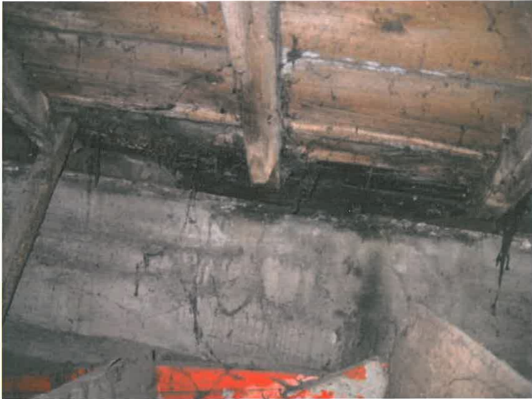
Foto 39 Door vocht en schimmel aangetast houtwerk a.g.v. lekkage.
