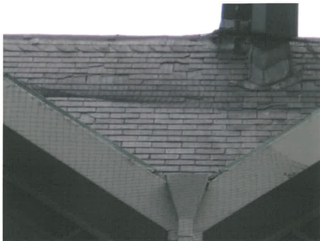
Foto 15 Diverse beschadigde en weggevallen leien onder de dakruiter.
