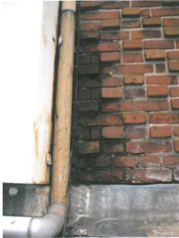
Foto 93 Nat muurwerk a.g.v. lekkage van de hemelwaterafvoer.
