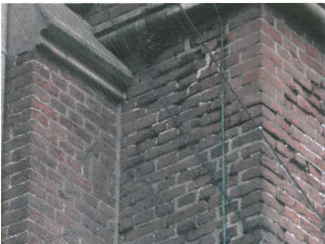
Foto 68 Slecht voegwerk toren.
