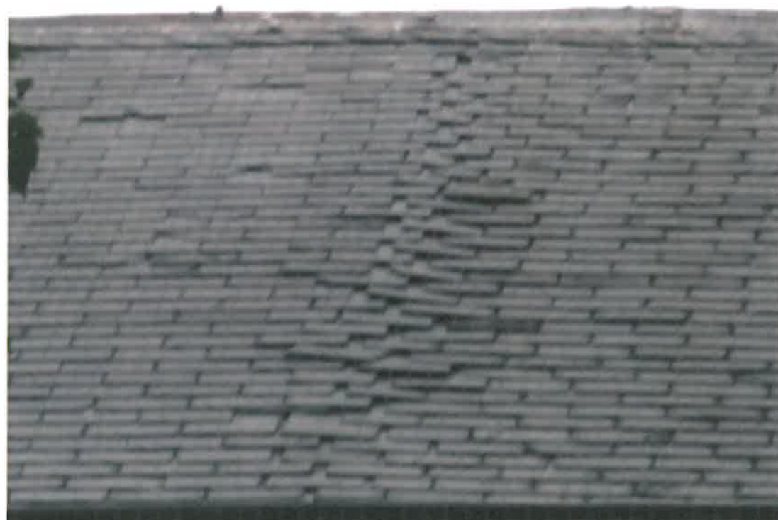
Foto 10 Slechte leibedekking t.p.v. het nieuwe koor. Plaatselijk zijn leien weggefallen.
