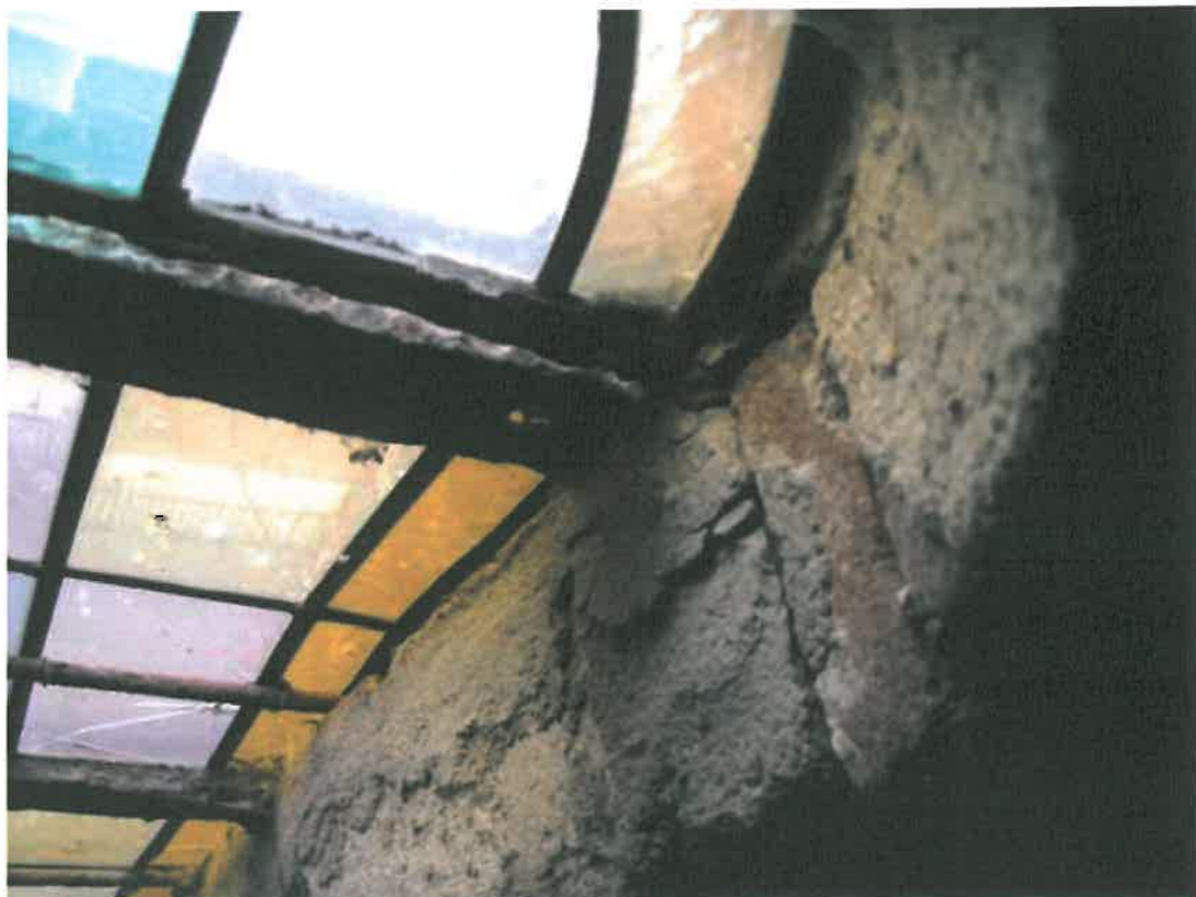
Foto 49 Slecht brugijzer van een glas in loodraam van de toren.
