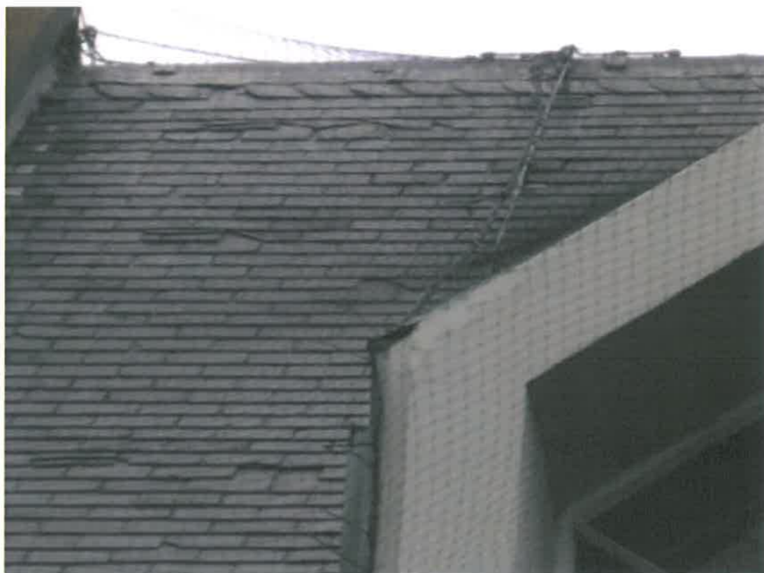
Foto 13 Op diverse plaatsen weggevallen leien.
