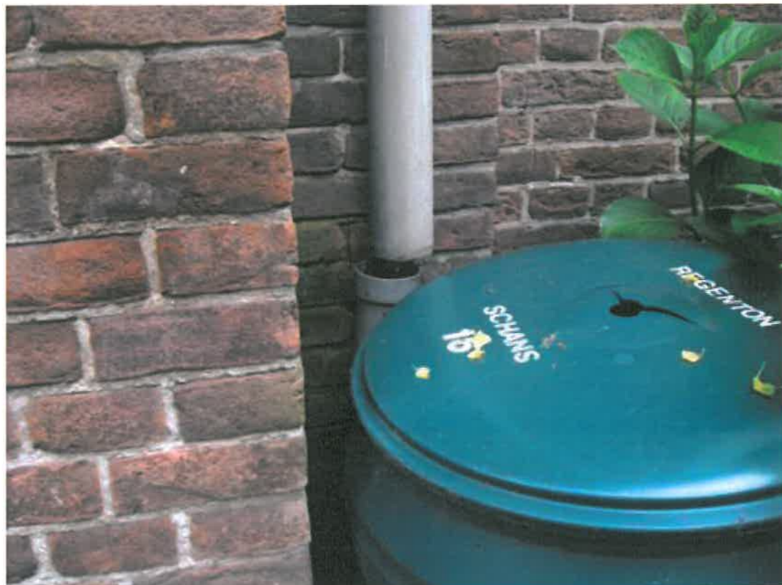
Foto 104 Lekkende losgeraakte hemelwaterafvoer.
