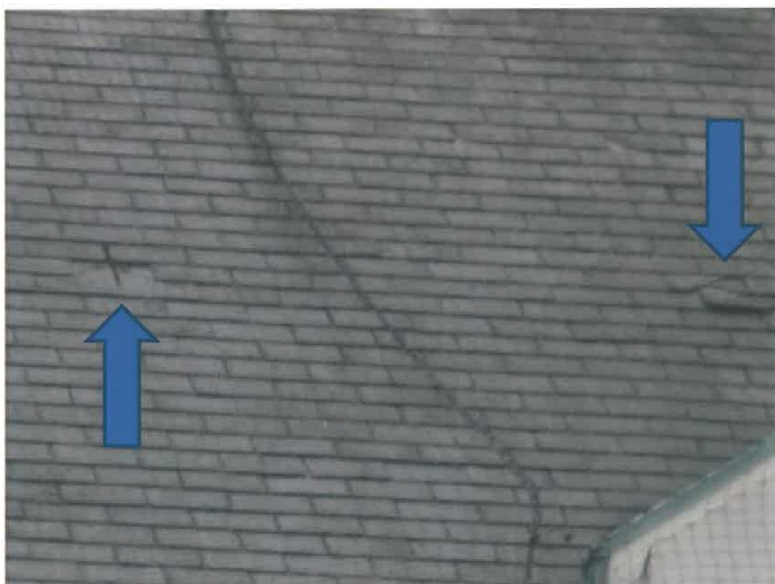
Foto 16 Plaatselijk weggevallen en/of beschadigde leien.
