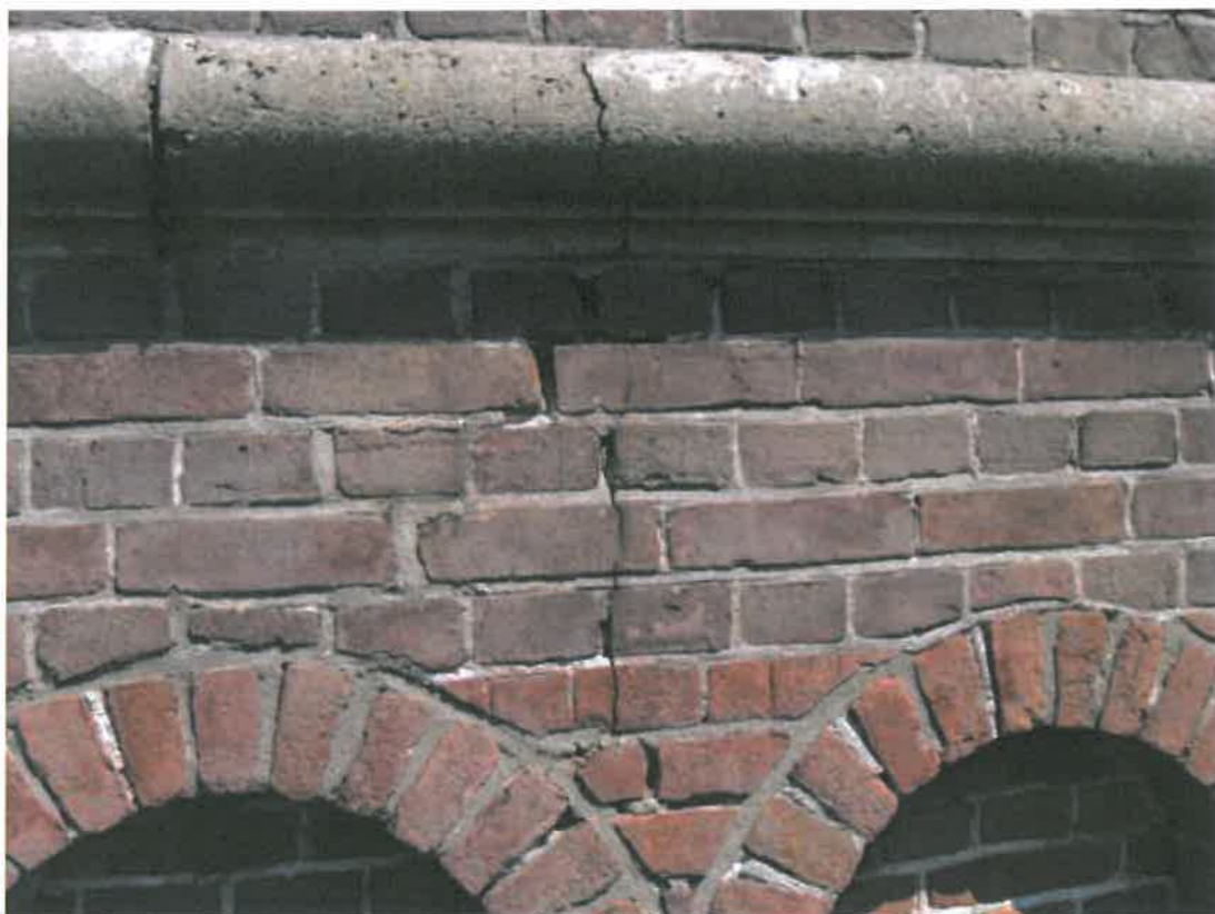
Foto 67 Scheur in het metselwerk van de toren.
