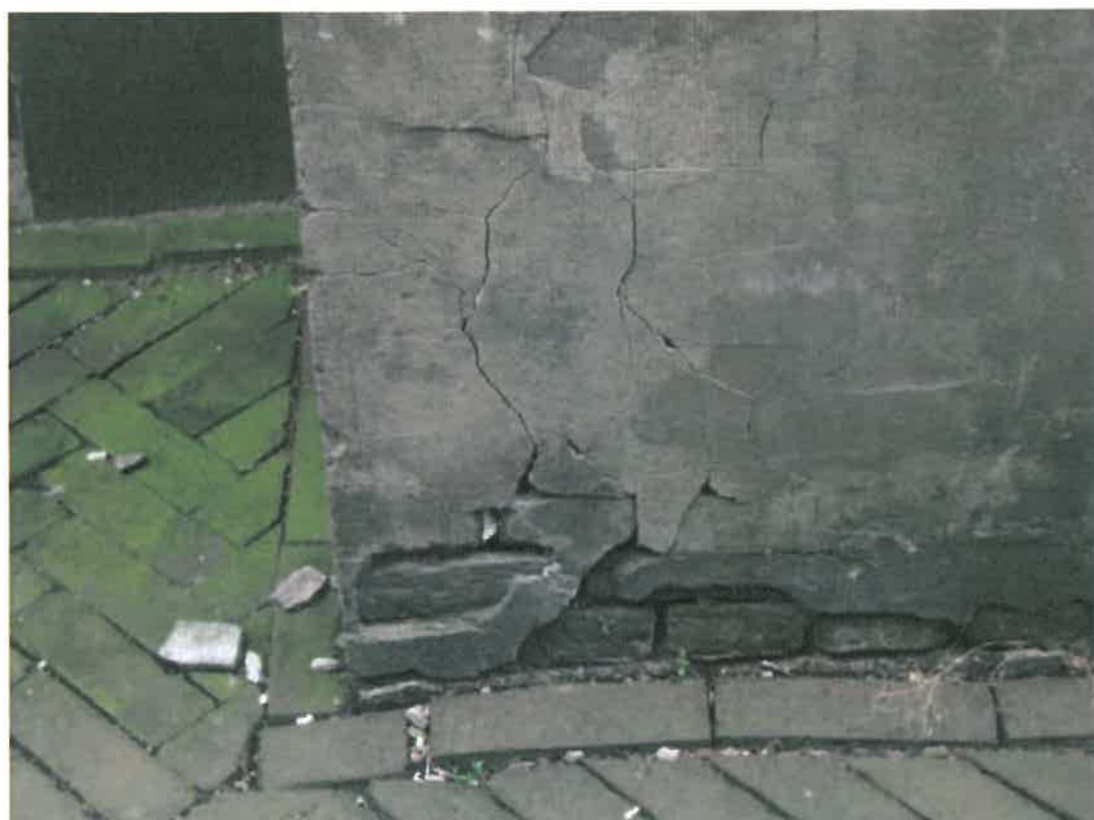
Foto 98 Slecht pleisterwerk van de plint.
