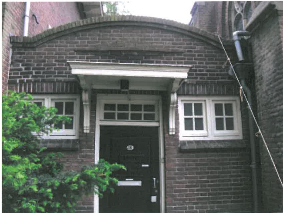
Foto 135 De doorgang tussen kerk en pastorie is verzakt, mogelijk a.g.v. het verzakken van de torens.
