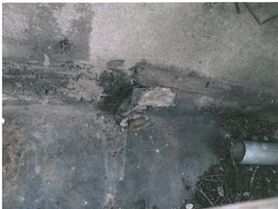
Foto 64 De loden vloer onder de luidklokken is gescheurd.
