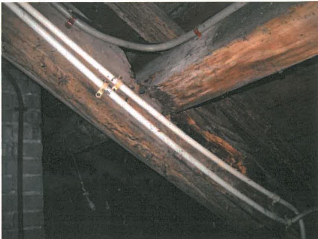
Foto 28 Ernstig door houtrot aangetast spant a.g.v. lekkage in de zijbeuk.
