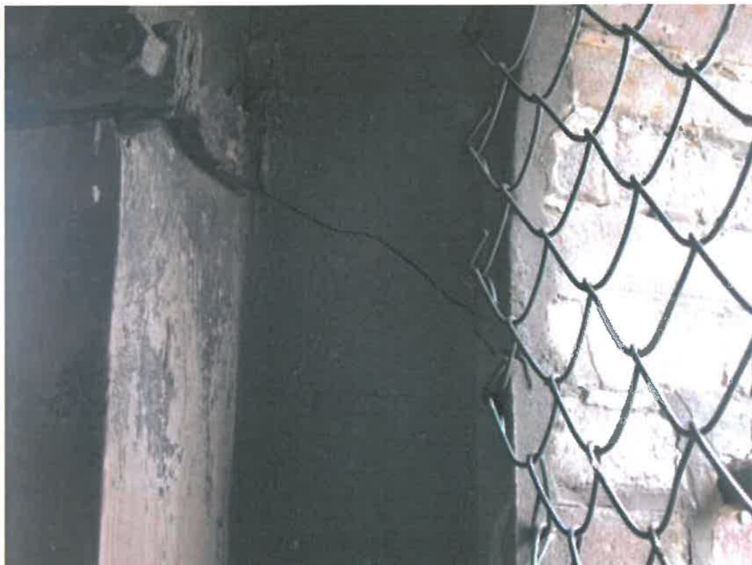
Foto 56 Scheur in het metselwerk a.g.v. het corroderen van het ringanker en de verankering van de houten torenconstructie.
