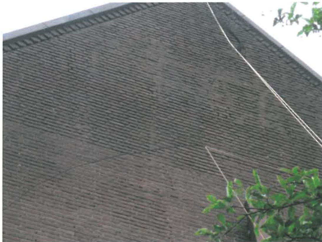
Foto 103 Slecht voegwerk van de topgevel.
