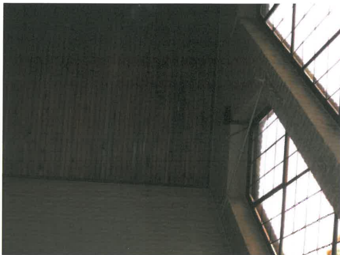
Foto 117 Door vocht aangetast plafond a.g.v. lekkage.
