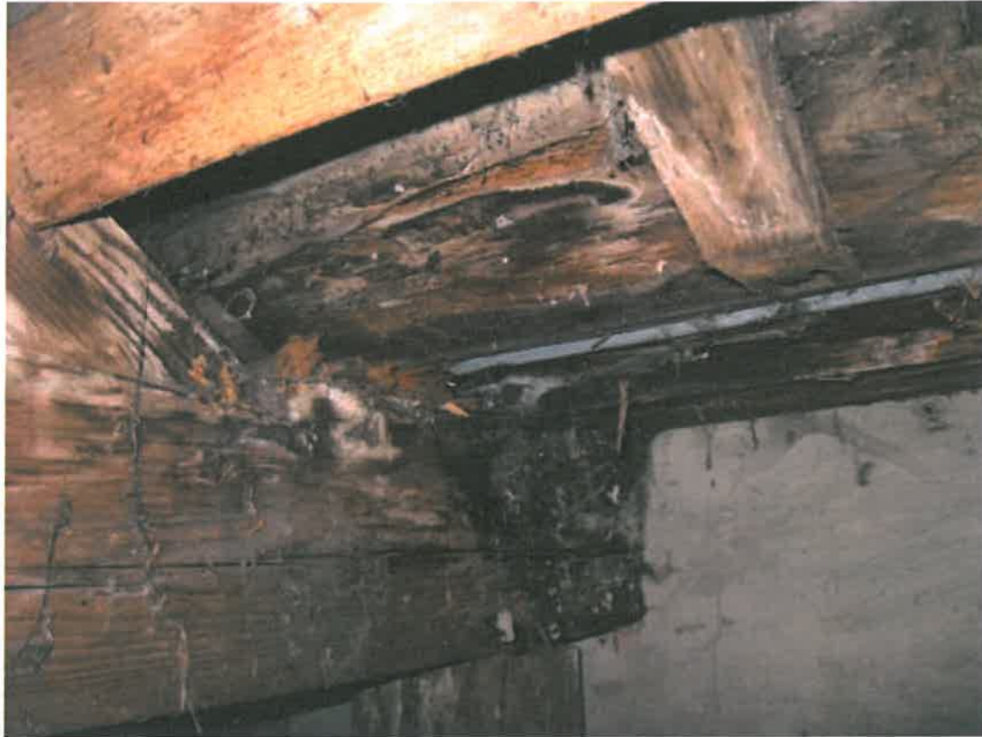
Foto 33 Door houtrot en zwam aangetast houtwerk a.g.v. lekkage.
