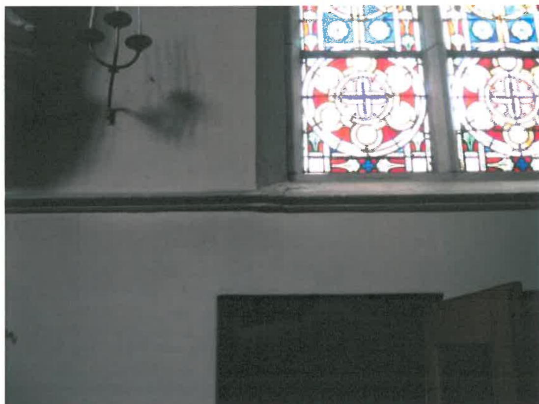
Foto 128 Scheur onder een venster.
