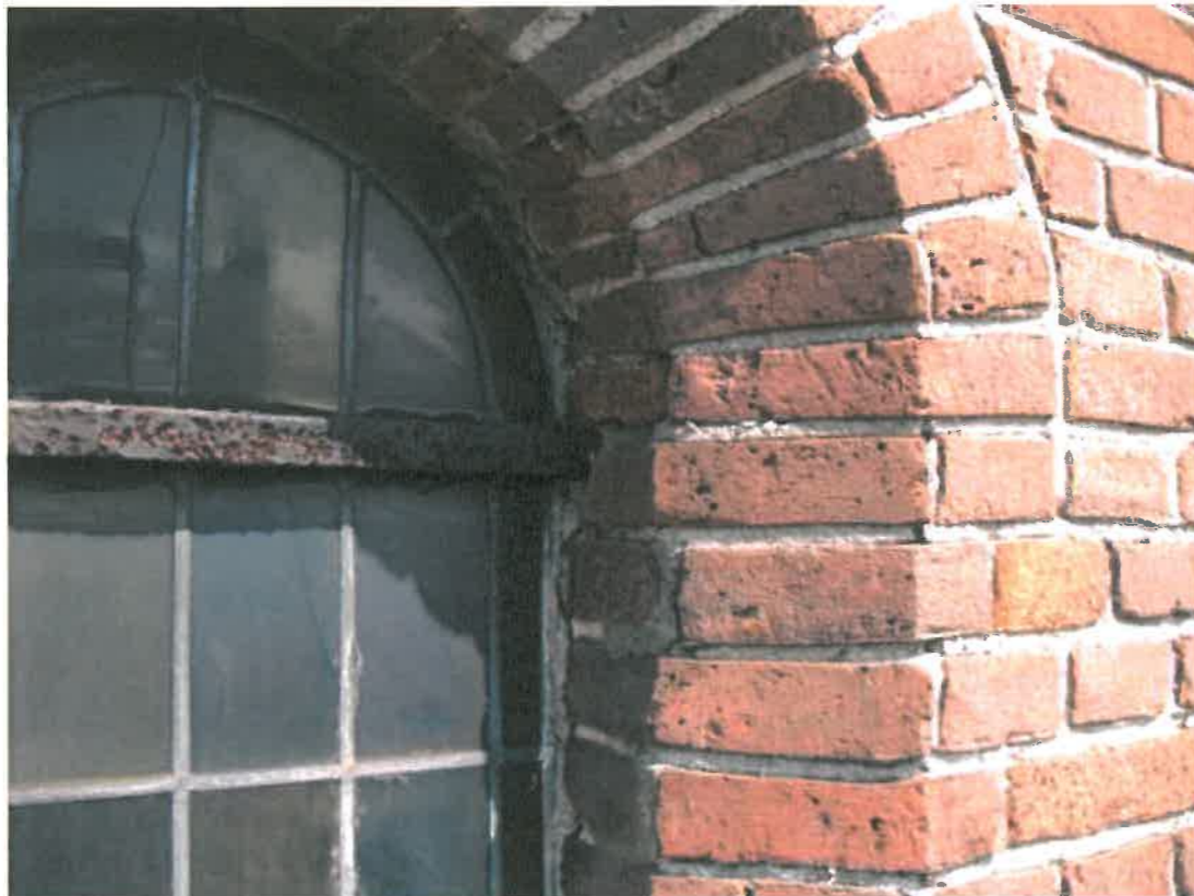
Foto 72 Ernstig gecorrodeerd brugijzer.
